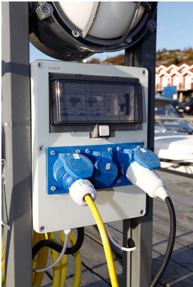
Elcentral för anslutning av CEE kontakter.
